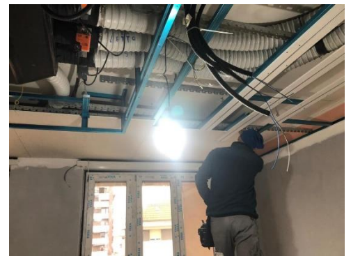
Contro soffittatura decorativa a copertura di impianto di condizionamento canalizzato
